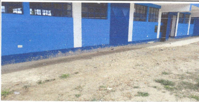
Foto 3: Patio de Escuela en mal estado
