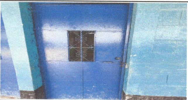
Foto 5. Chapas de puertas deterioradas.
