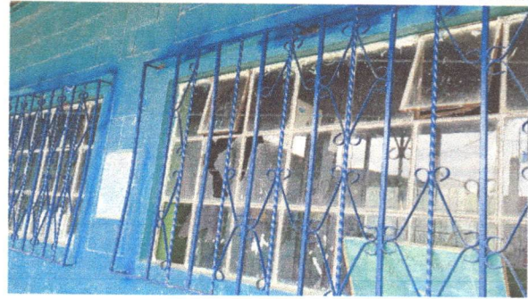
Foto 2: vidrios y balcones deterioradas
