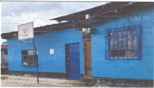
Foto 4: pintura de la Escuela deteriorada
